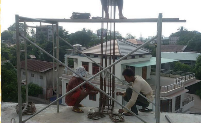
安全対策がされていない建設現場
